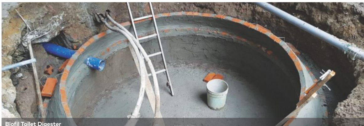
Biofil Toilet Digester
